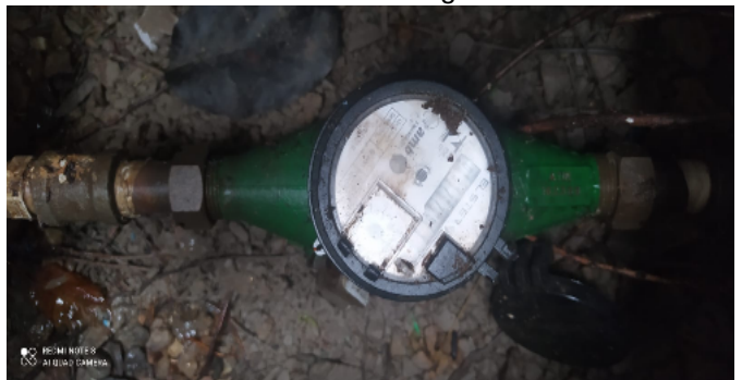
Contador de Agua
