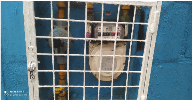
Contador de Gas
