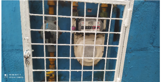
Contador de Gas
