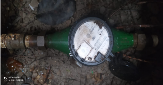
Contador de Agua
