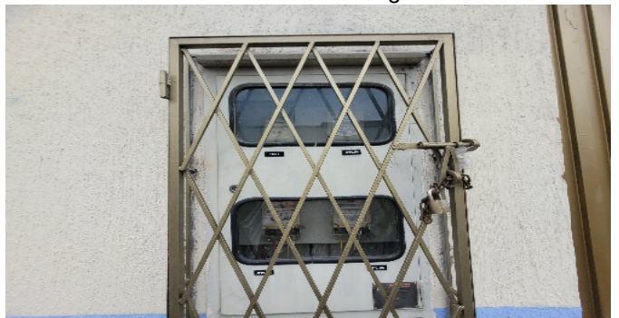
Contador de Energia
