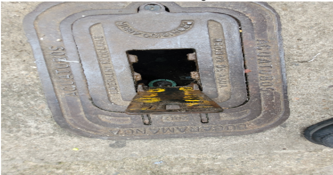
Contador de Agua
