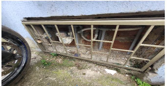
Contador de Gas
