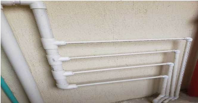
Contador de Agua
