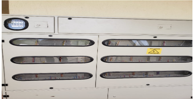
Contador de Energia
