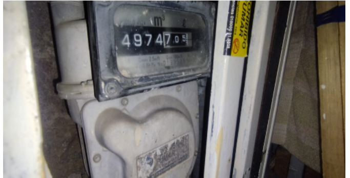
Contador de Gas
