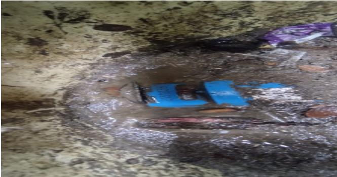
Contador de Agua
