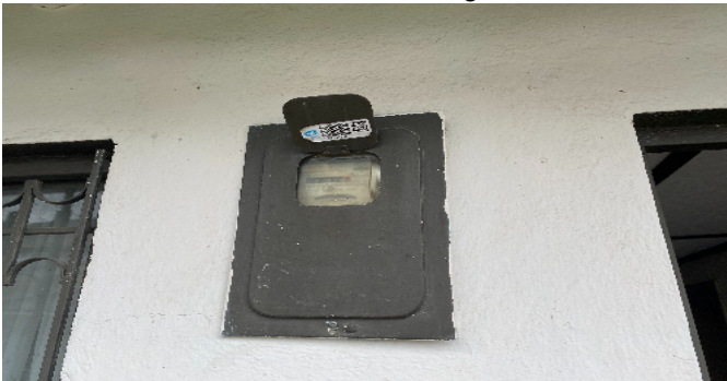
Contador de Energia
