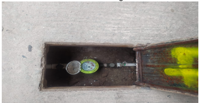
Contador de Agua
