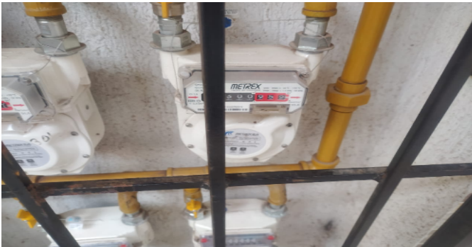
Contador de Gas
