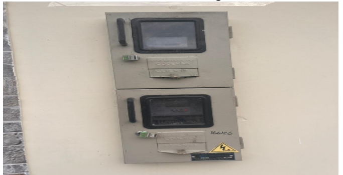
Contador de Energia
