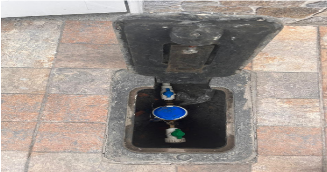
Contador de Agua
