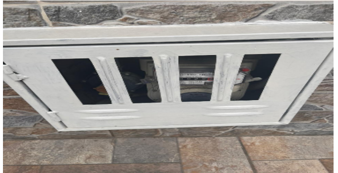
Contador de Gas
