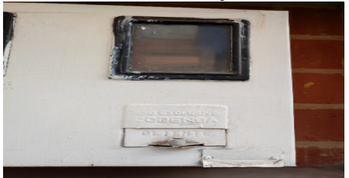
Contador de Energia
