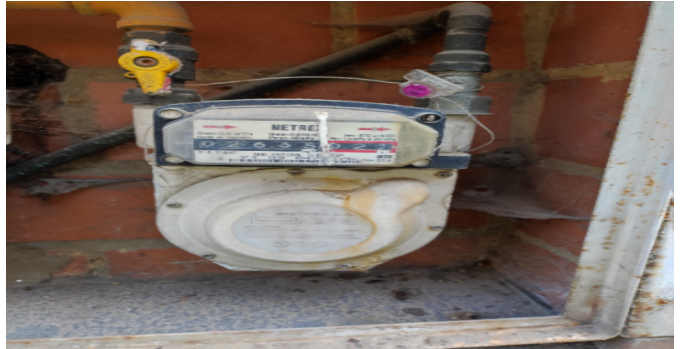
Contador de Gas
