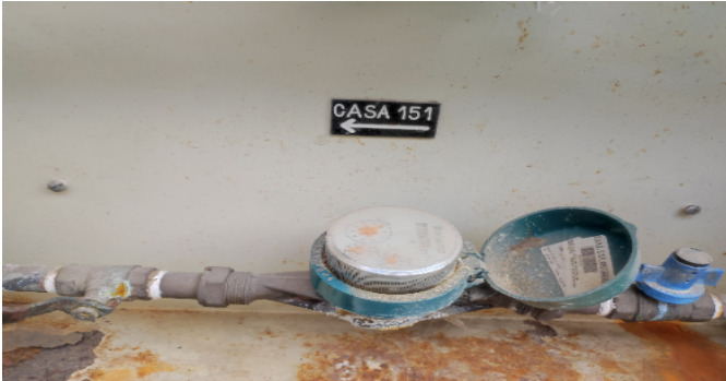
Contador de Agua
