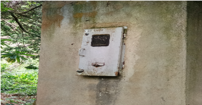
Contador de Energia
