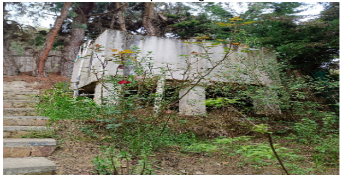
Tanque de agua
