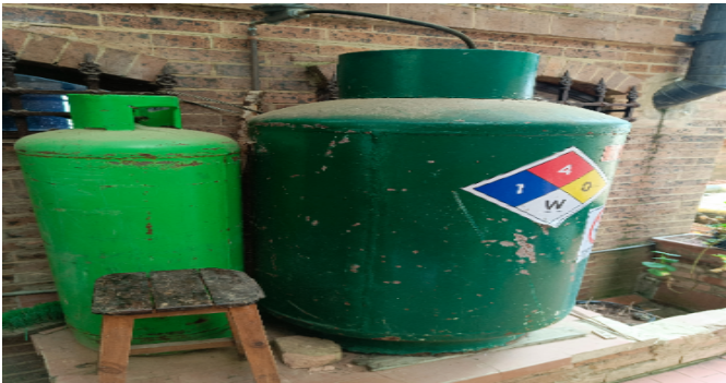
Contador de Gas
