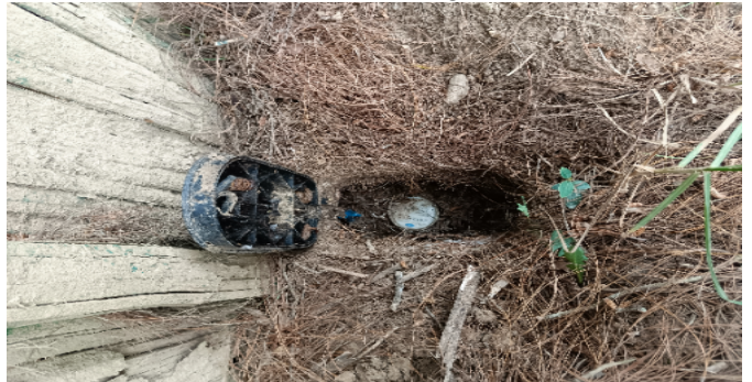
Contador de Agua
