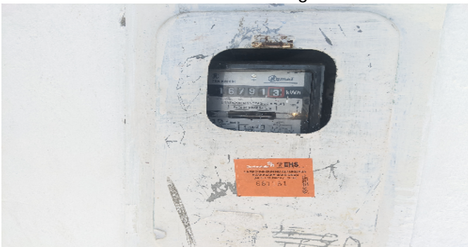
Contador de Energia
