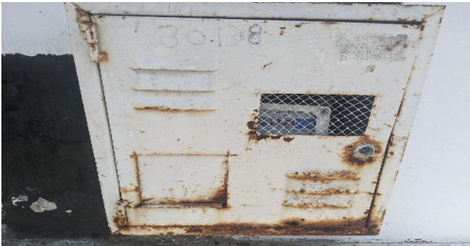
Contador de Gas
