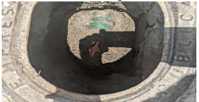
Contador de Agua
