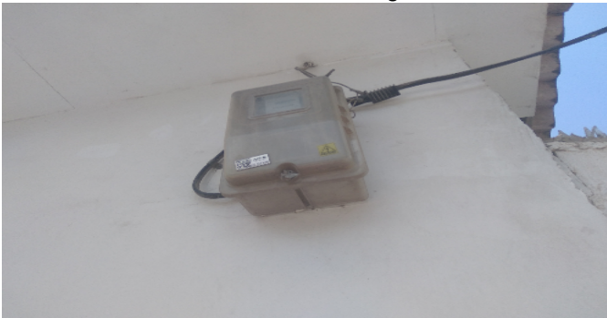
Contador de Energia
