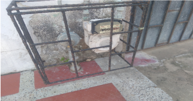
Contador de Gas
