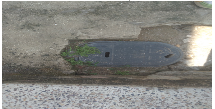
Contador de Agua
