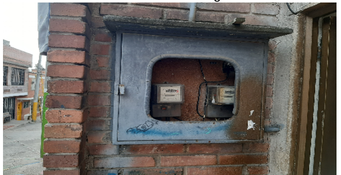
Contador de Energia
