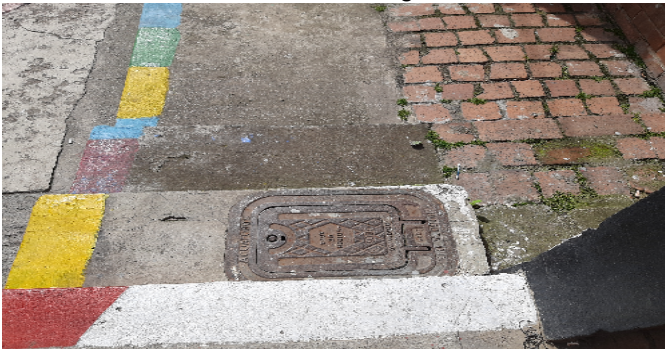
Contador de Agua
