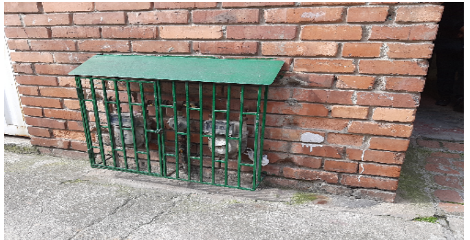
Contador de Gas
