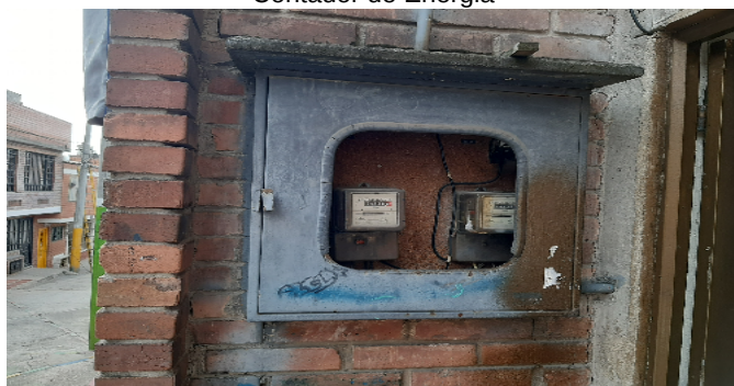
Contador de Energia
