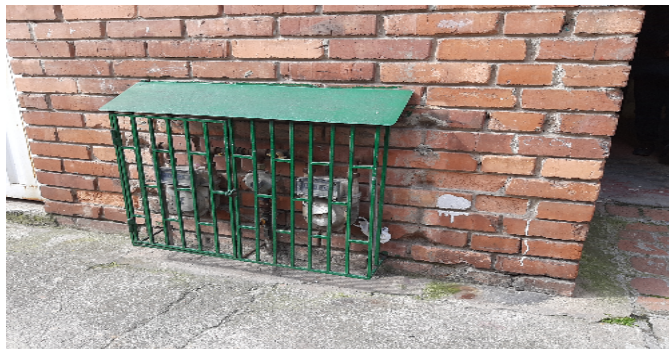
Contador de Gas
