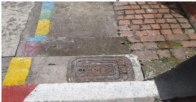
Contador de Agua
