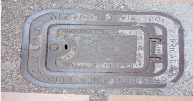
Contador de Agua
