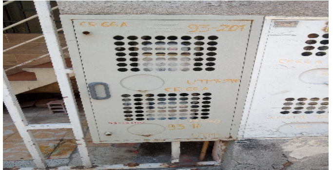
Contador de Gas
