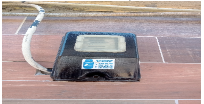
Contador de Energia
