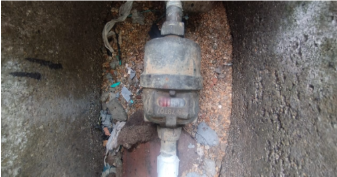
Contador de Agua
