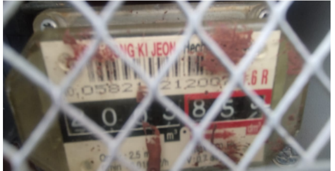
Contador de Gas
