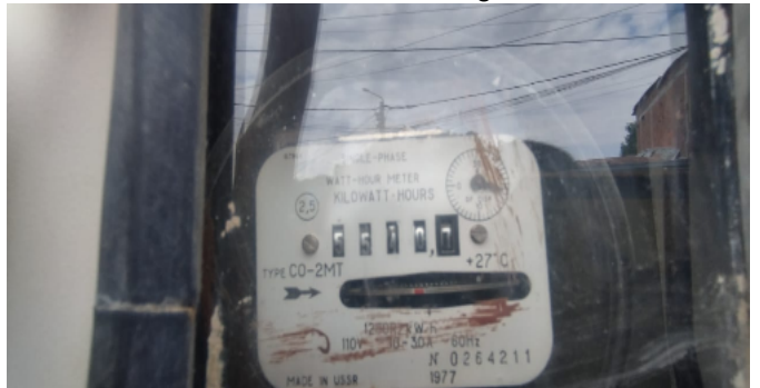
Contador de Energia
