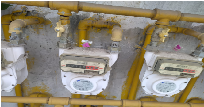
Contador de Gas
