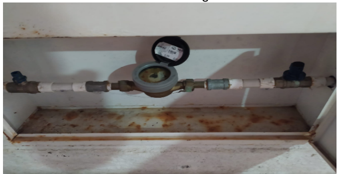
Contador de Agua
