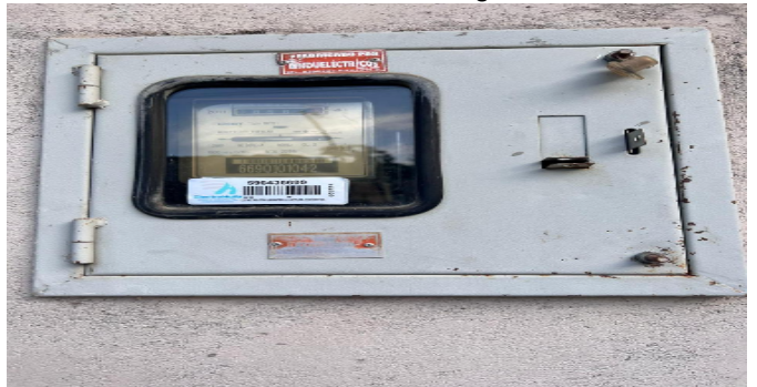
Contador de Energia
