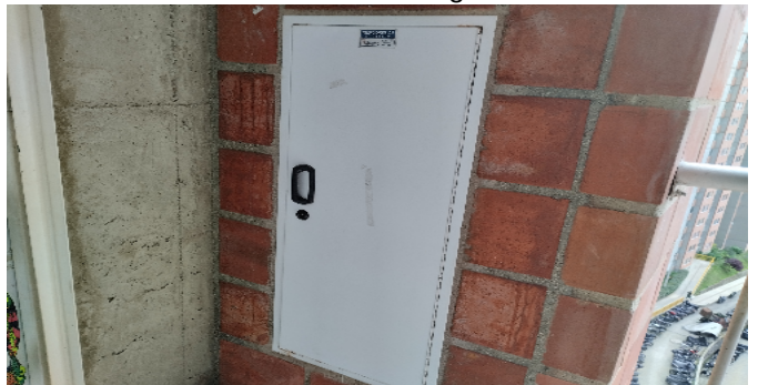
Contador de Agua
