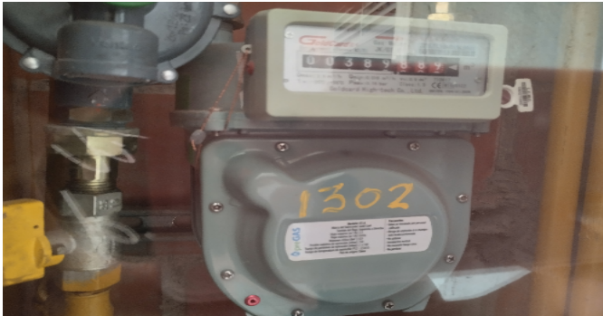
Contador de Gas
