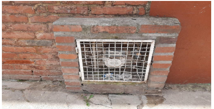
Contador de Gas
