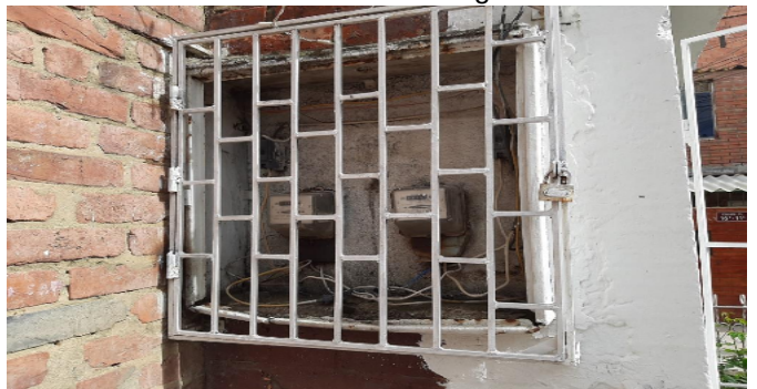
Contador de Energia
