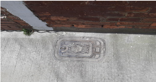
Contador de Agua
