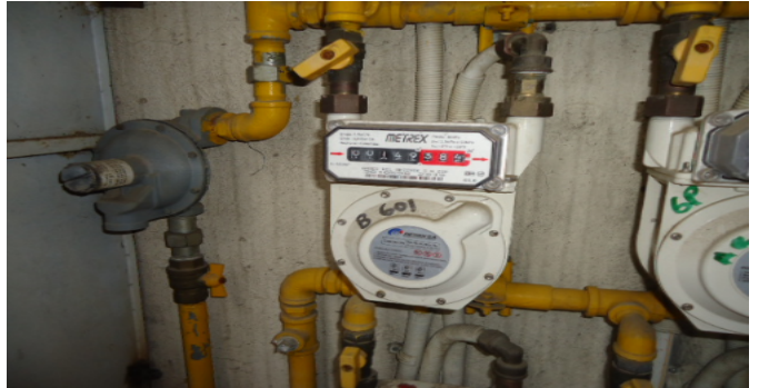
Contador de Gas
