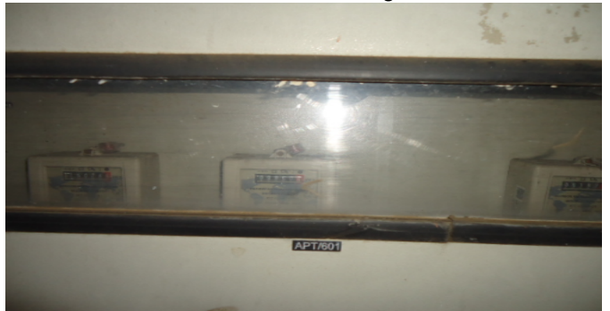
Contador de Energia
