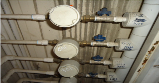
Contador de Agua
