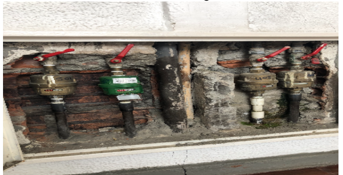
Contador de Agua
