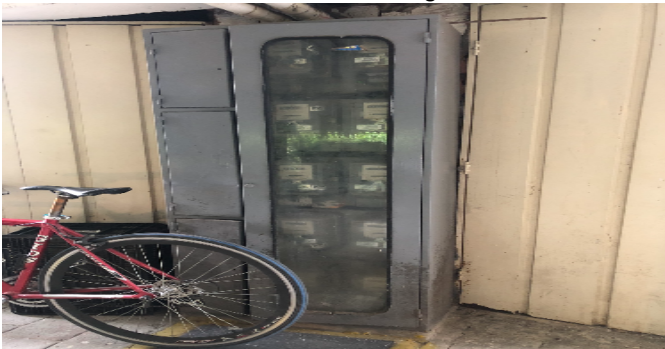
Contador de Energia
