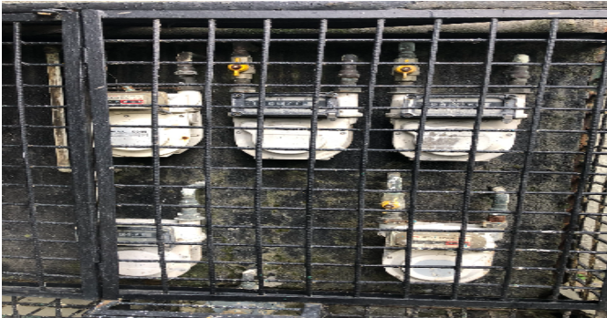
Contador de Gas
