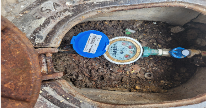
Contador de Agua
