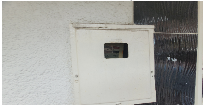
Contador de Energia
