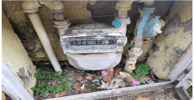
Contador de Gas
