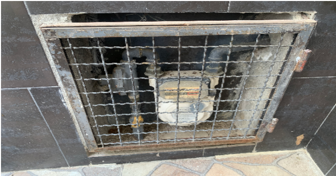
Contador de Gas
