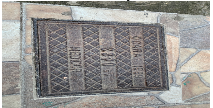
Contador de Agua
