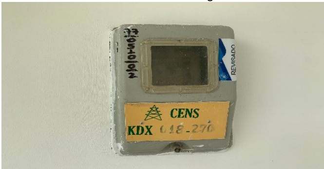
Contador de Energia
