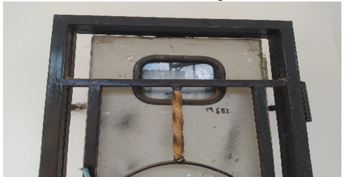
Contador de Energia
