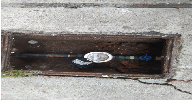
Contador de Agua
