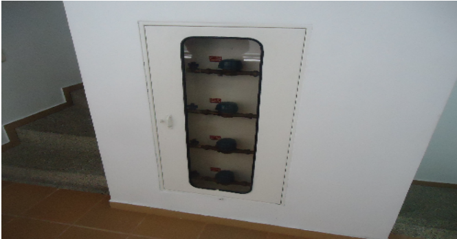
Contador de Agua
