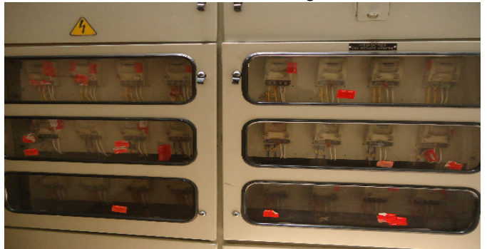
Contador de Energia
