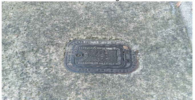
Contador de Agua
