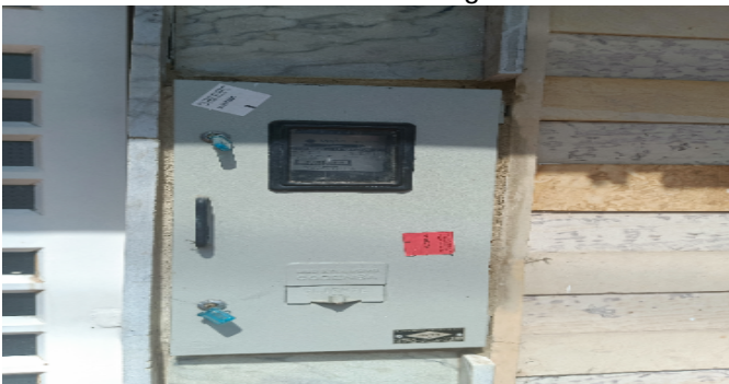
Contador de Energia
