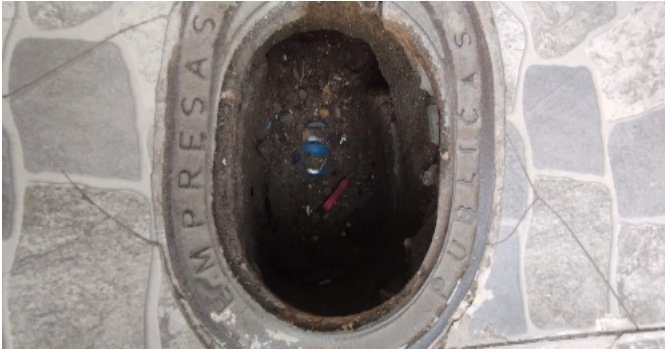
Contador de Agua
