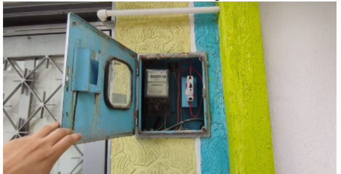
Contador de Energia
