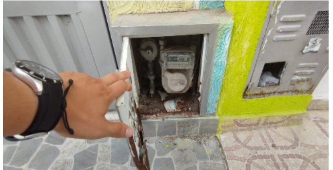
Contador de Gas
