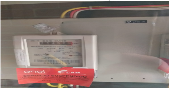
Contador de Energia
