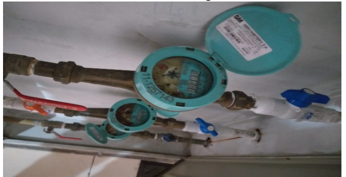
Contador de Agua
