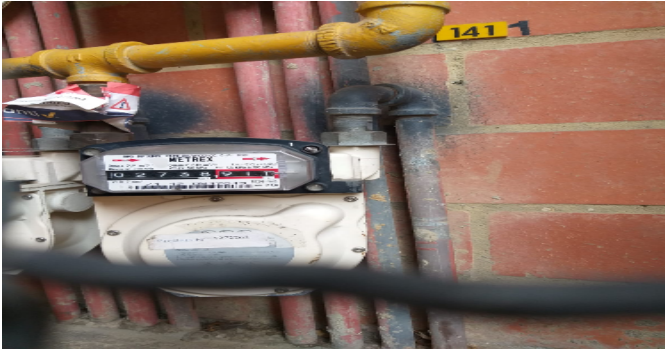
Contador de Gas
