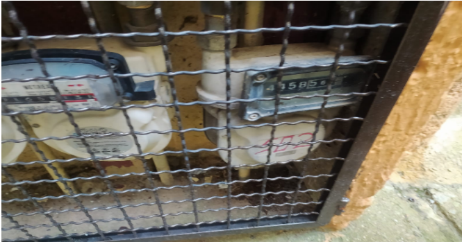
Contador de Gas
