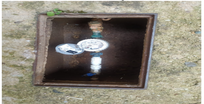
Contador de Agua
