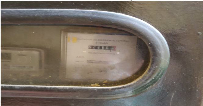
Contador de Energia
