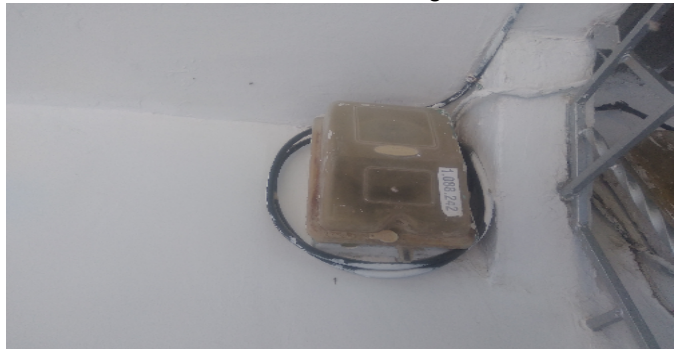
Contador de Energia
