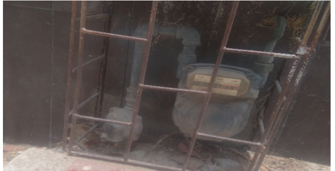
Contador de Gas
