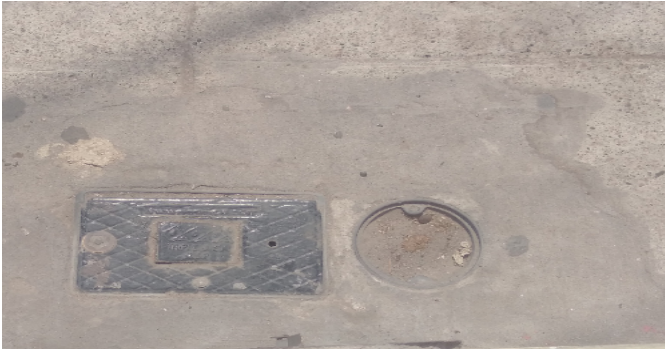
Contador de Agua
