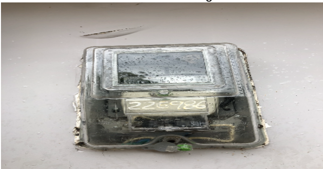
Contador de Energia
