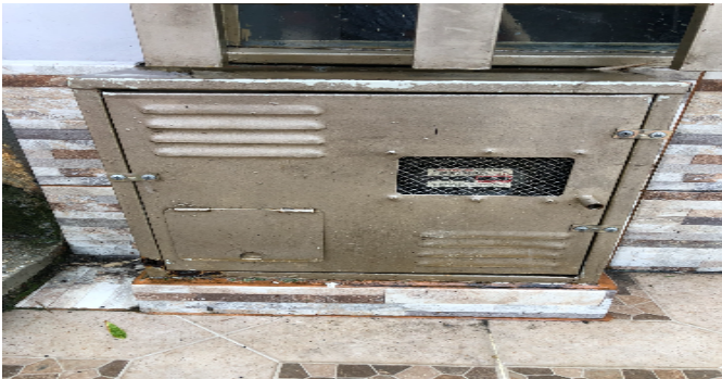
Contador de Gas
