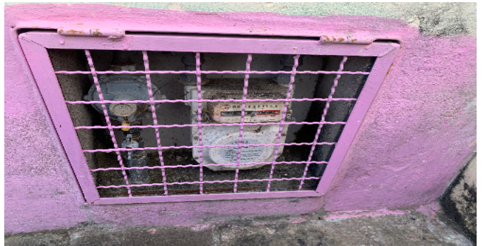
Contador de Gas
