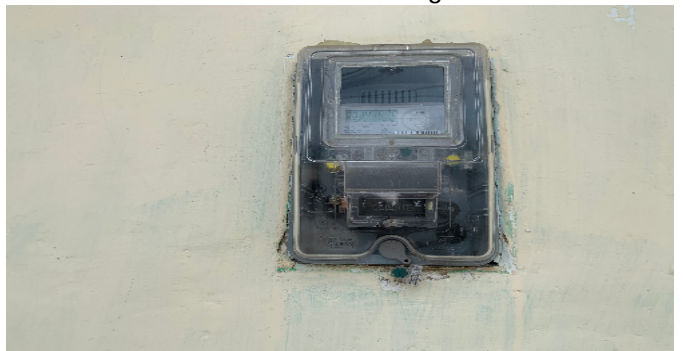
Contador de Energia
