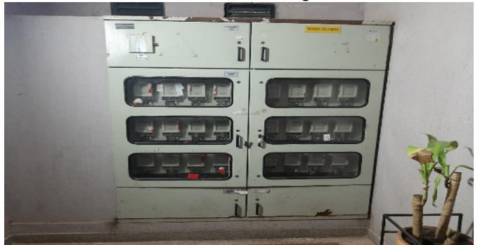
Contador de Energia
