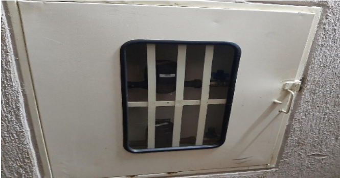
Contador de Agua
