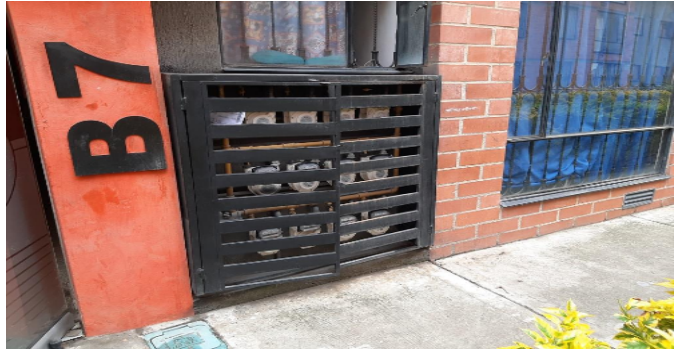
Contador de Gas
