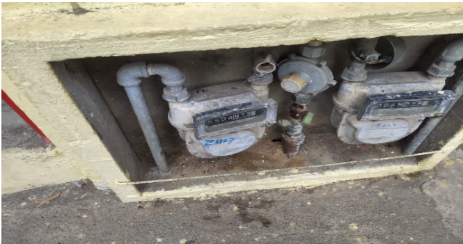
Contador de Gas
