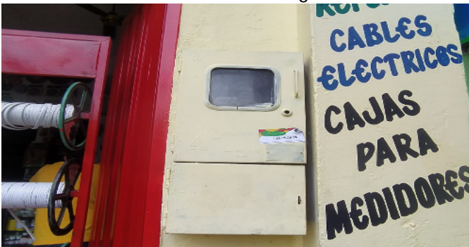
Contador de Energia
