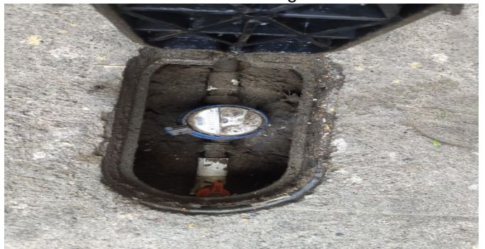
Contador de Agua
