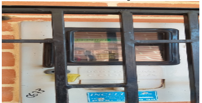
Contador de Energia
