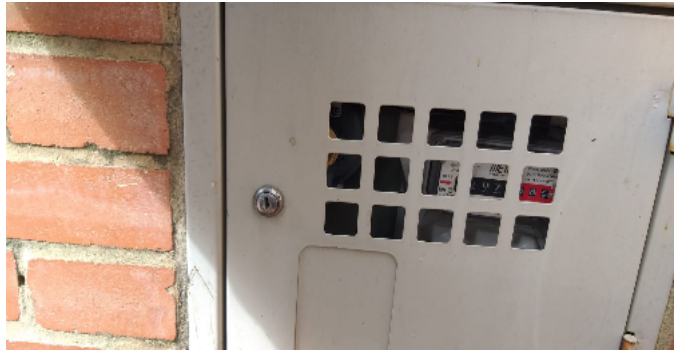
Contador de Gas
