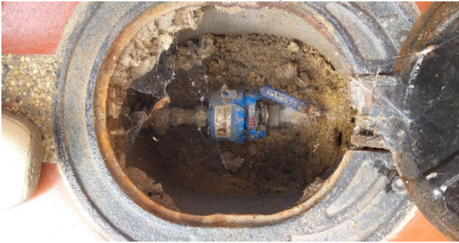
Contador de Agua
