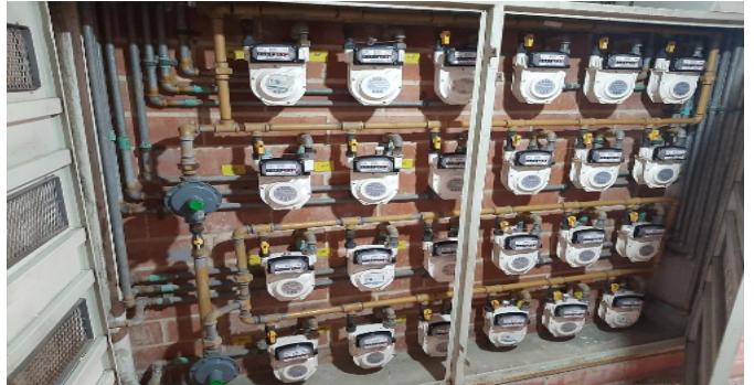
Contador de Gas
