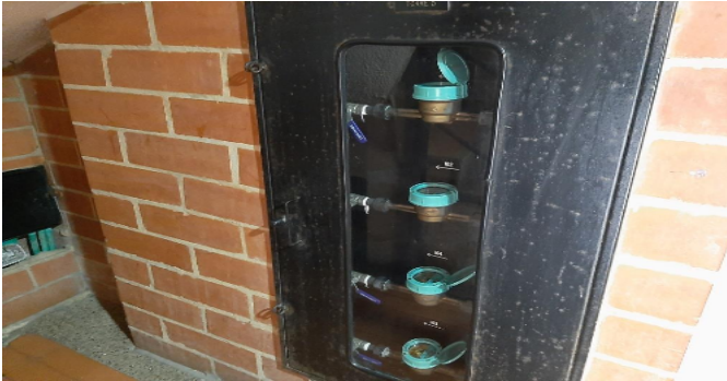
Contador de Agua
