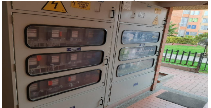
Contador de Energia
