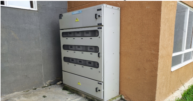
Contador de Energia
