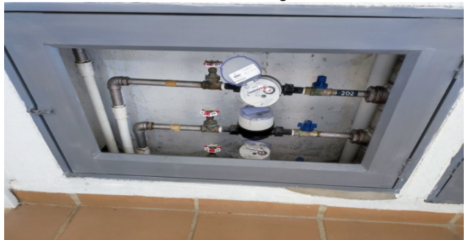
Contador de Agua
