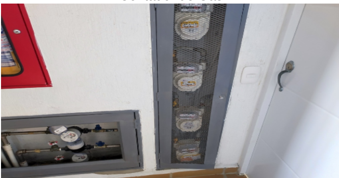
Contador de Gas
