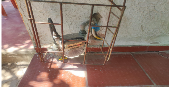
Contador de Gas
