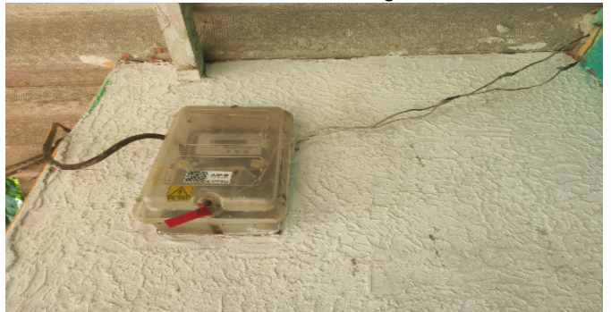
Contador de Energia
