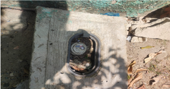
Contador de Agua
