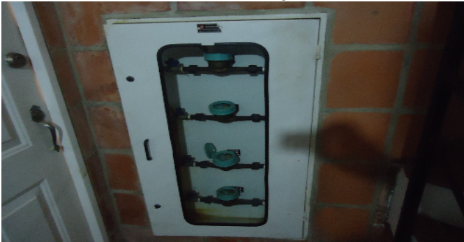
Contador de Agua
