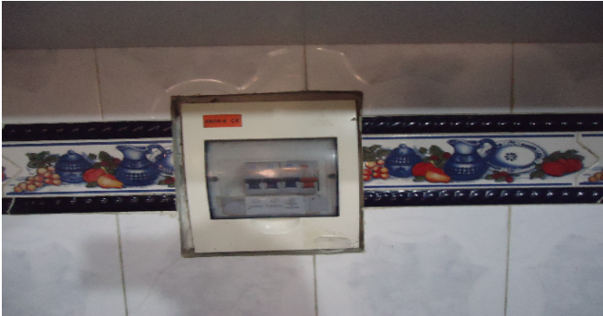
Contador de Energia
