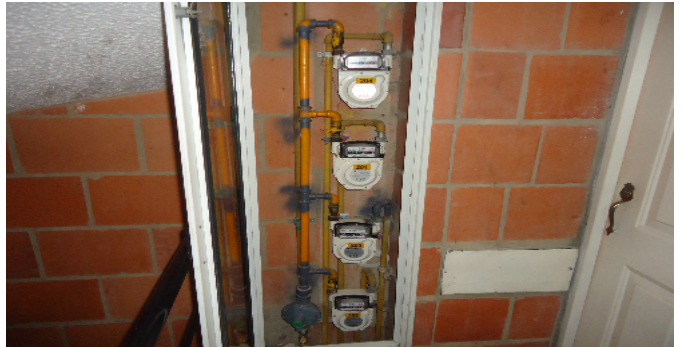
Contador de Gas
