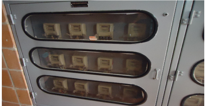
Contador de Energia
