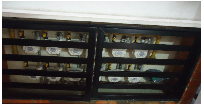
Contador de Gas
