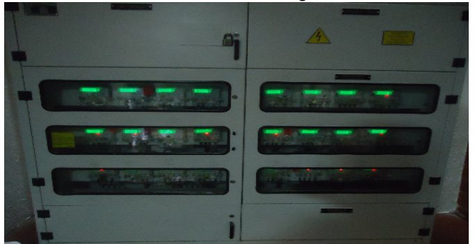
Contador de Energia
