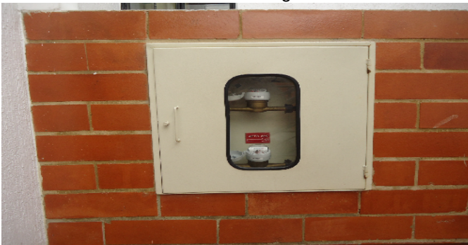
Contador de Agua
