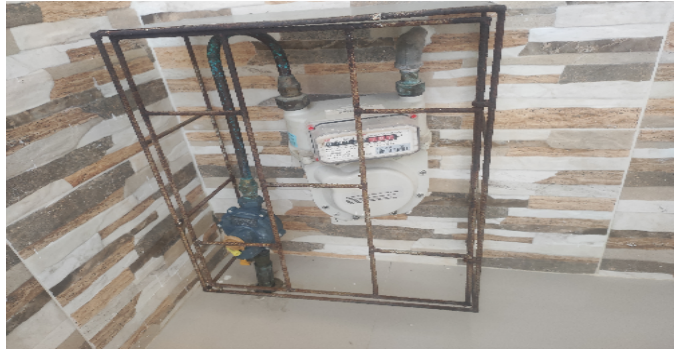
Contador de Gas
