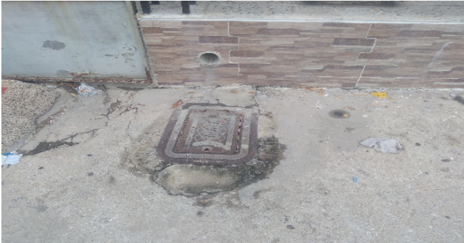
Contador de Agua
