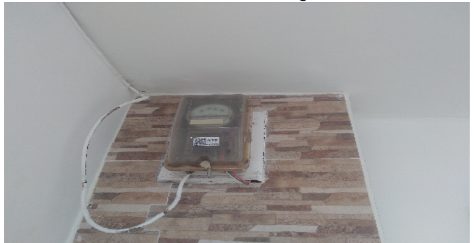
Contador de Energia
