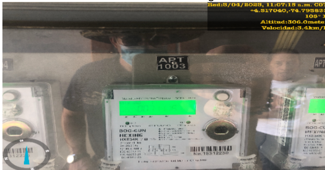
Contador de Energia
