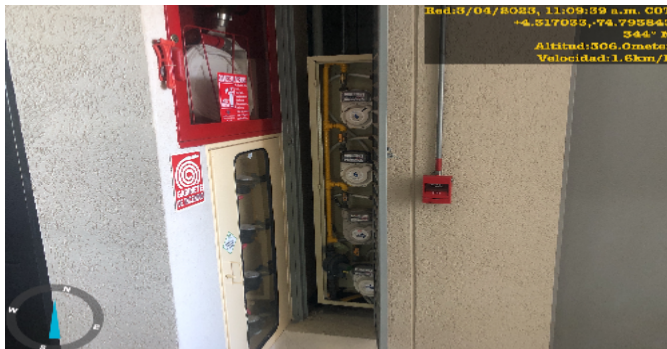
Contador de Gas
