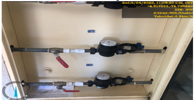
Contador de Agua
