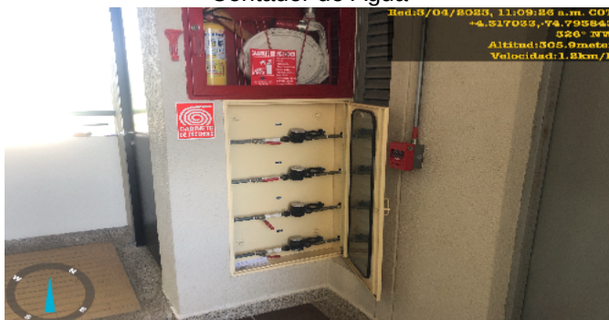
Contador de Agua
