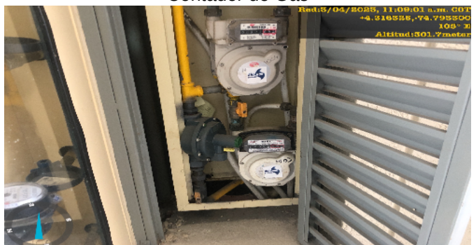
Contador de Gas
