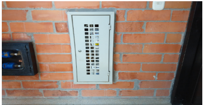
Contador de Gas
