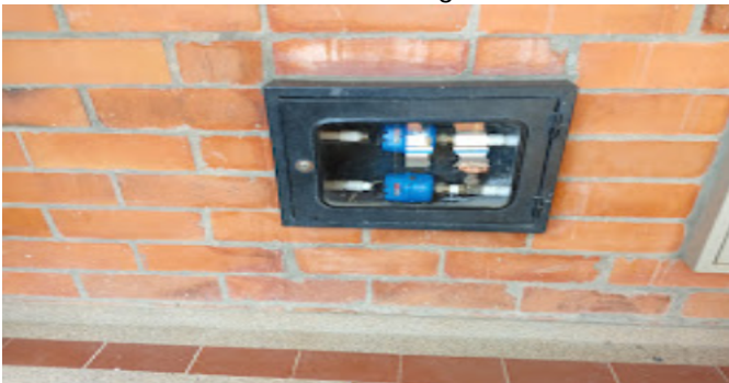
Contador de Agua
