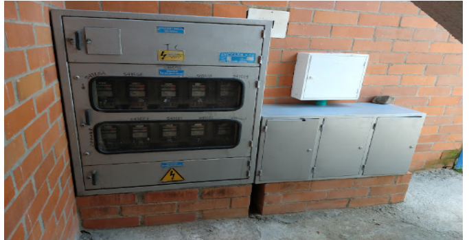
Contador de Energia
