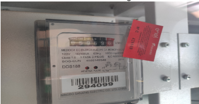
Contador de Energia
