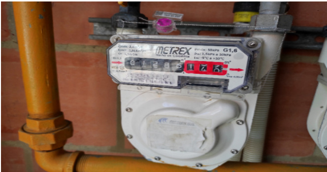
Contador de Gas
