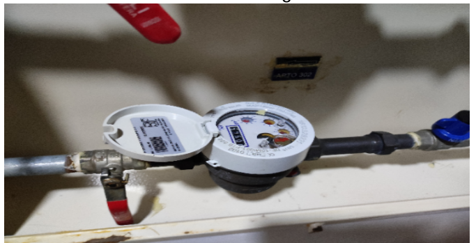
Contador de Agua
