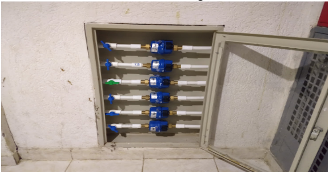
Contador de Agua
