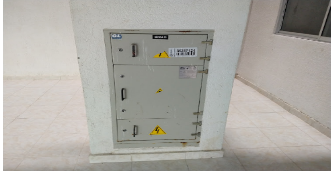
Contador de Energia
