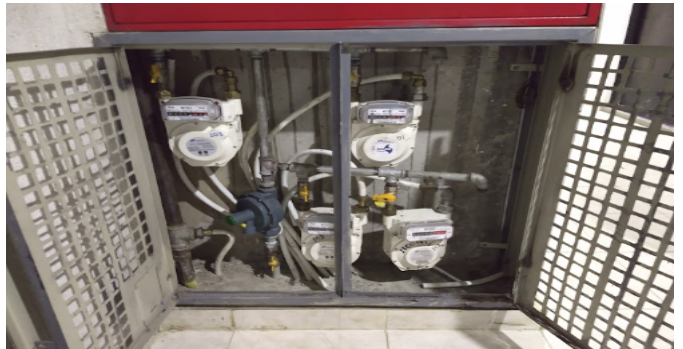
Contador de Gas
