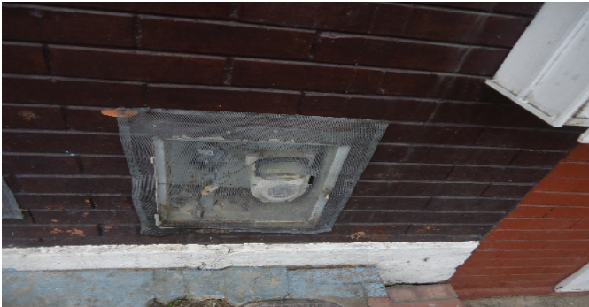
Contador de Gas
