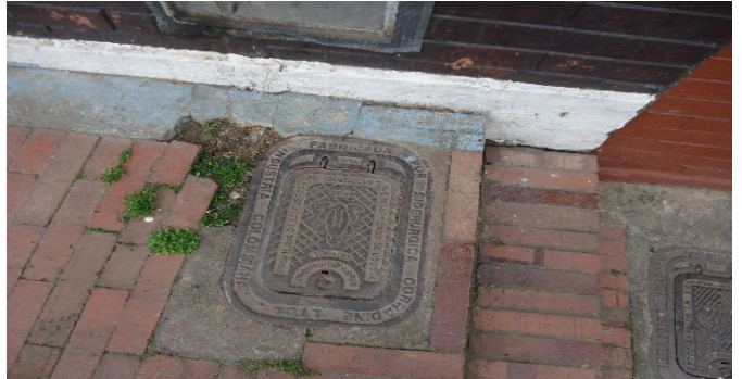
Contador de Agua
