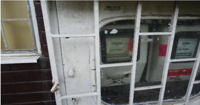
Contador de Energia
