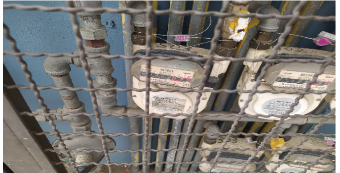
Contador de Gas
