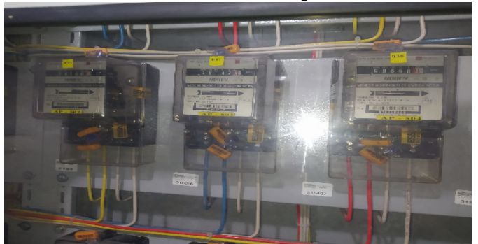
Contador de Energia
