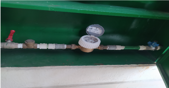
Contador de Agua
