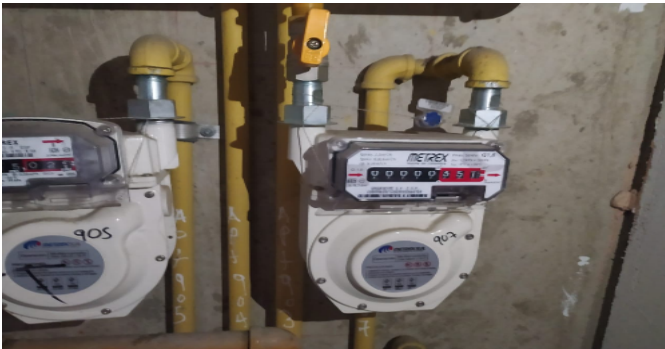
Contador de Gas
