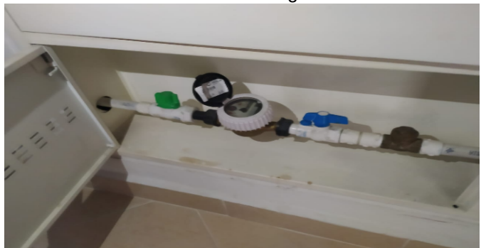
Contador de Agua
