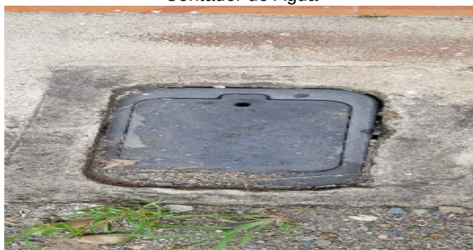
Contador de Agua
