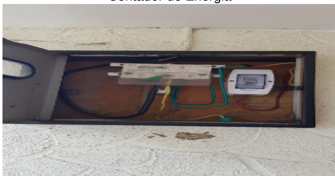
Contador de Energia
