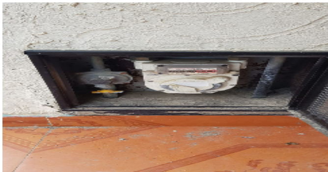
Contador de Gas
